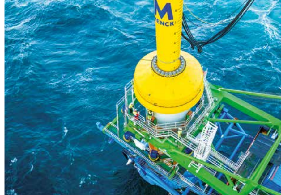
IN DER NORDSEE: Auch beim Bau des Offshore-Windparks Sandbank kamen die Rammen von Menck zum Einsatz. Hier mussten insgesamt 72 Windturbinen aufgestellt werden.
