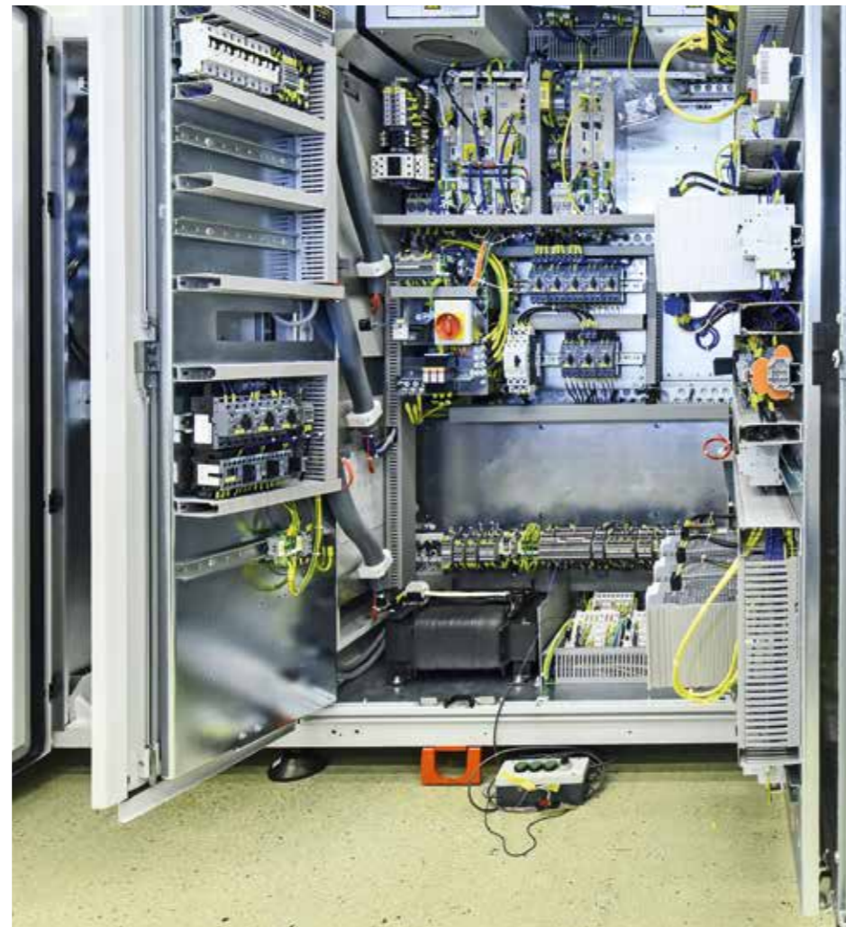
KOMPAKTES INNENLEBEN: Schaltschränke an der Rückseite der Hamburger Trinkhalmmaschine.
