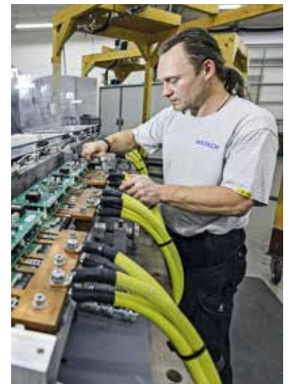
ANSCHLUSS: Thorsten Anders fixiert Stromkabel an Leistungsmodulen.
