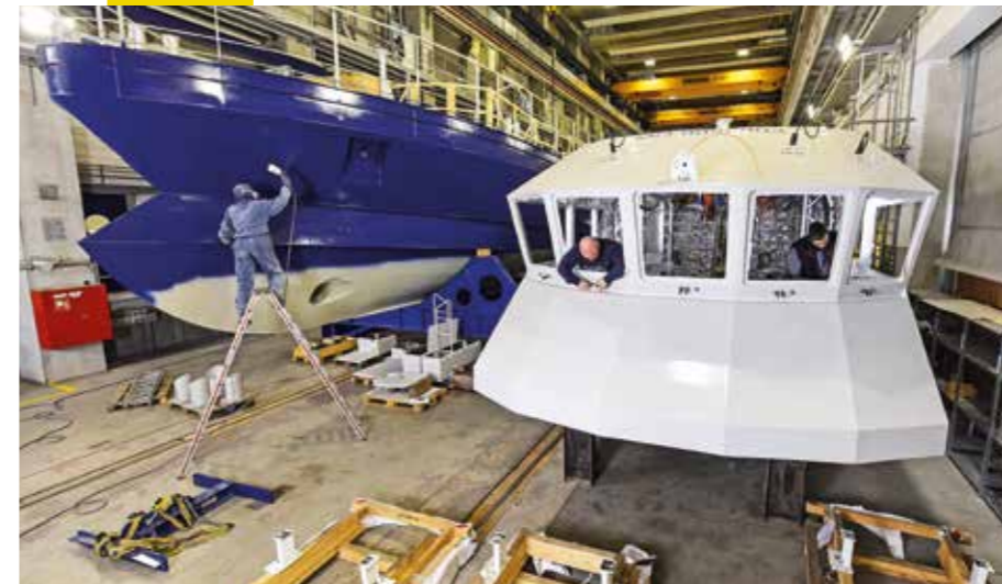
PARALLELE PRODUKTION: Um den Bau der beiden Zollboote effektiv zu gestalten, werden Rumpf und Deckshaus getrennt voneinander gefertigt und erst dann zusammengefügt.
