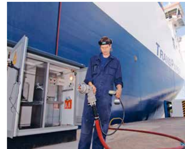
HISTORISCH: Die Anlage in Lübeck war europaweit der erste Landstromanschluss für die kommerzielle Schifffahrt.
