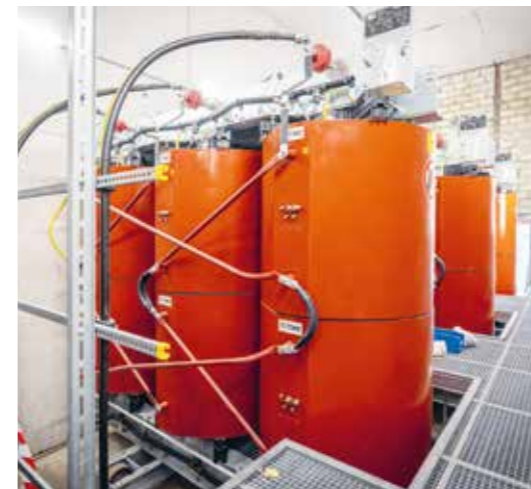
GROSSES KALIBER: Ein Blick in die Landstromanlage am Kieler Ostuferhafen, die nun eingeweiht wurde.
