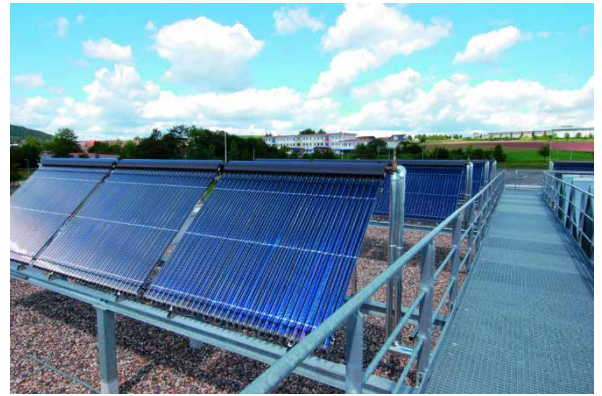
Vakuum-Röhrenkollektoren einer solarthermischen Anlage (Quelle: Viessmann Werke)
