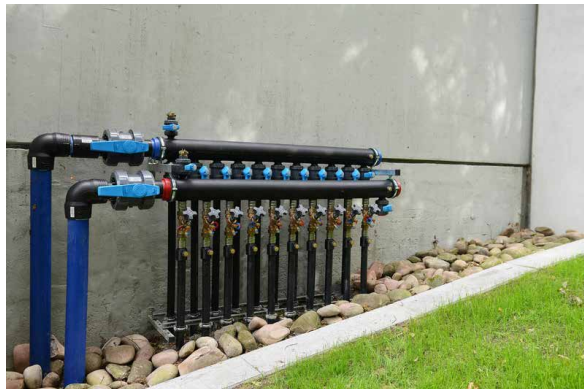
Erdwärmesonden (Quelle: BWP)
