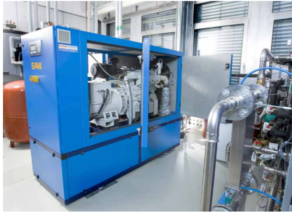
BHKW als Teil eines virtuellen Kraftwerks (Quelle: Siemens AG)
