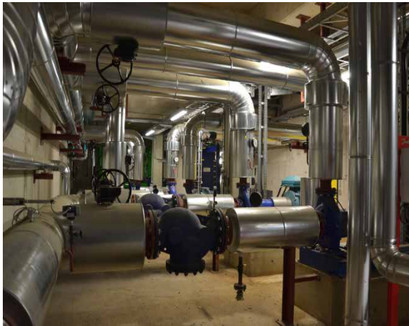
Bioenergieanlage zur Wärme- und Stromerzeugung (Quelle: ÖBMV-Bilderdatenbank/Bioenergie Steyr)
