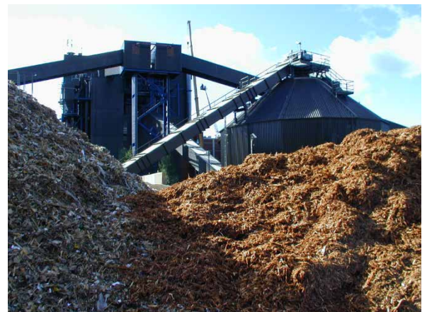
Biomasseheizkraftwerk (Quelle: TUHH)
