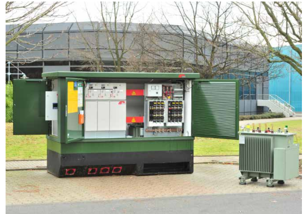
Ortsnetzstation für Smart Grid (Quelle: Siemens AG)
