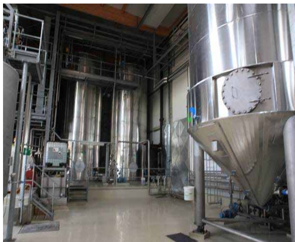
Komponenten einer Bioethanolproduktionsanlage (Quelle: ÖBMV-Bilderdatenbank)
