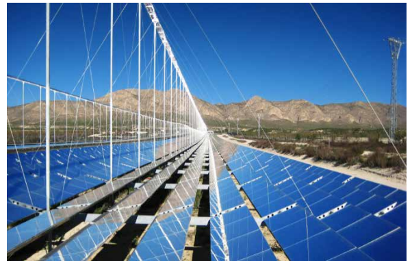
Fresnelkollektoren (Quelle: DLR)
