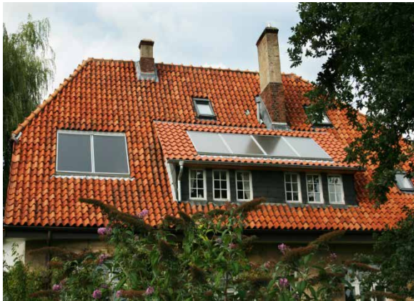
Solarthermische Kollektoren (Quelle: Solvis)
