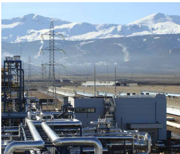
Kraftwerksteil einer Solarfarmanlage (Quelle: Fichtner)
