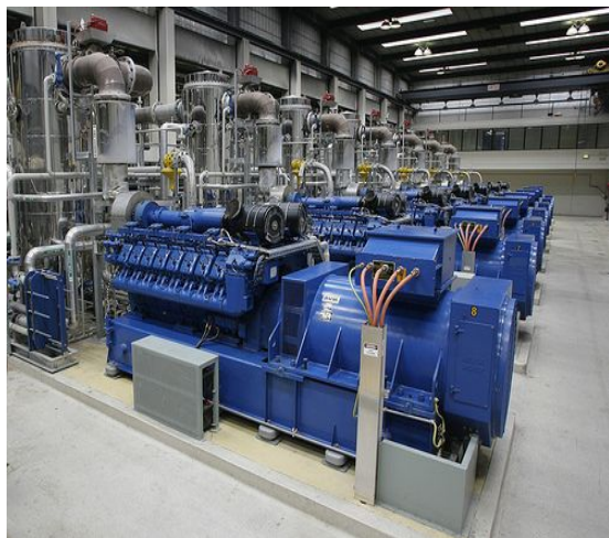
BHKW für Deponiegas (Quelle: Catepillar Energy Solutions)
