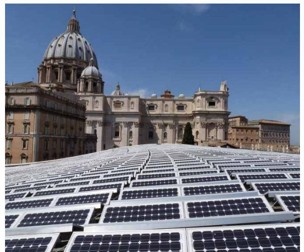
Fotovoltaikmodule im Vatikan (Quelle: BSW-Solar/Bianca Barth)
