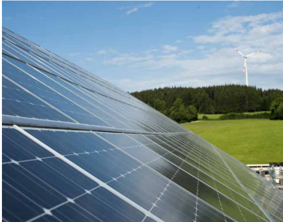
Dachmontierte Fotovoltaikanlage (Quelle: Siemens AG)
