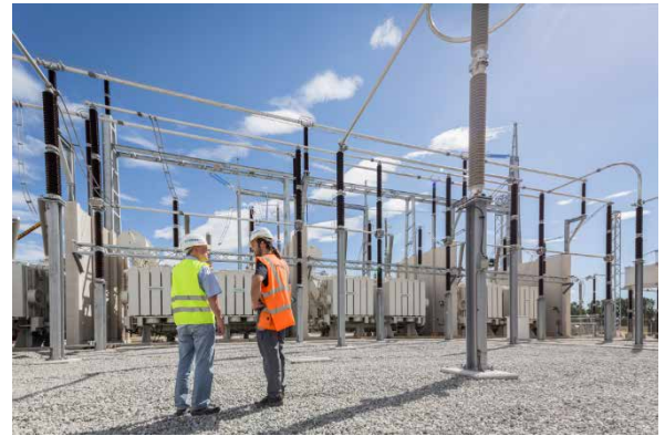
Stromrichterstation der HGÜ-Verbindung Frankreich-Spanien (Quelle: Siemens AG)
